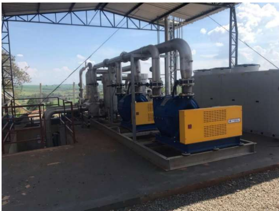
Figura 6-7 – Aterro de Cesário Lange, estrutura gerador biogás. Fonte: CONSÓRCIO CM (2021)
