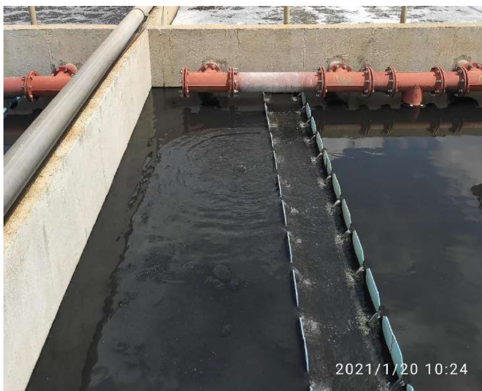
Figura 5-12 – Reator Secundário da ETE Sede Fonte: CONSÓRCIO CM (2021)
