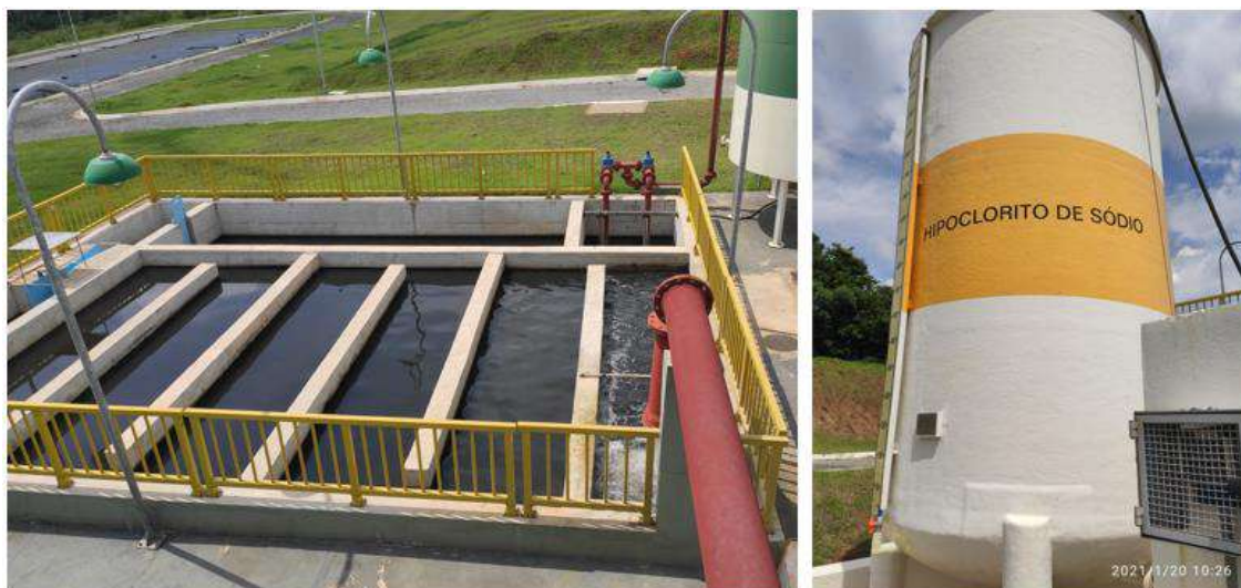
Figura 5-13 – Tanque de contato e desinfecção da ETE Sede Fonte: CONSÓRCIO CM (2021)
