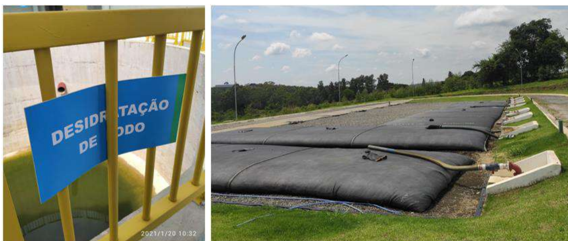
Figura 5-14 – Tanque de contato e desinfecção da ETE Sede Fonte: CONSÓRCIO CM (2021)
