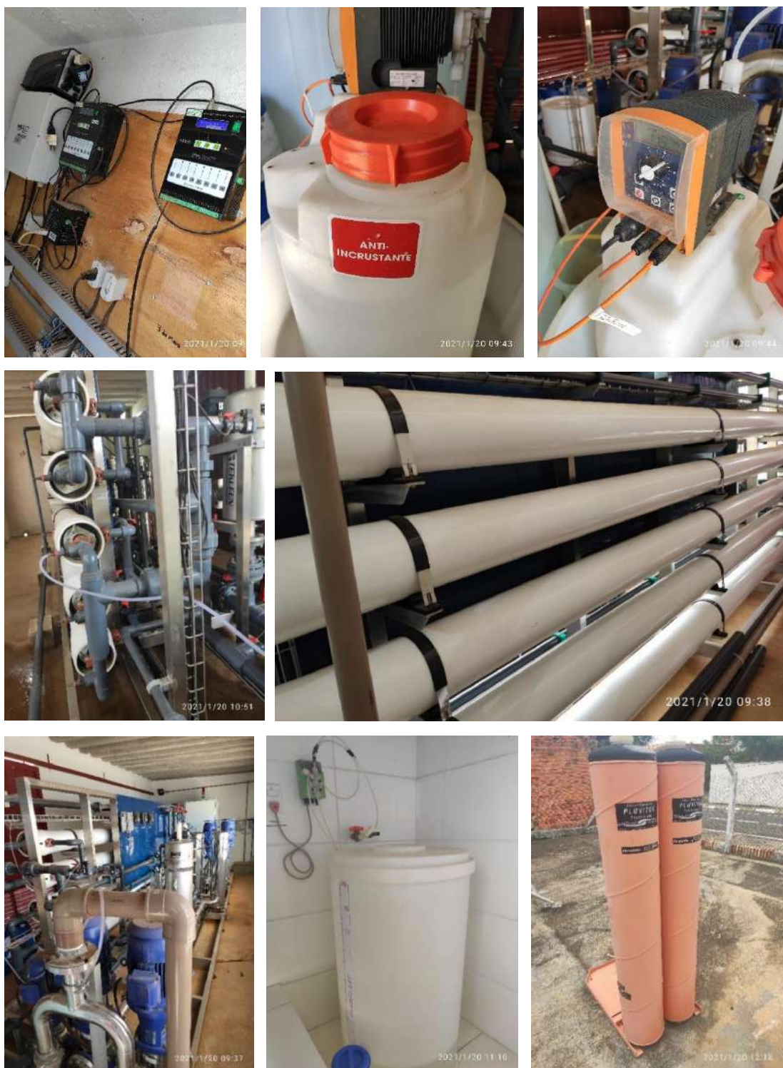
(A) Medidor de vazão; (B) Armazenamento de insumos; (C) Dozadora; (D) nano filtração - lateral; (E) nano filtração - frontal; (F) Equipamentos auxiliares da nano filtração; (E) Dosador de Cloro – CR Torninos; (D) Abrandador P02;
