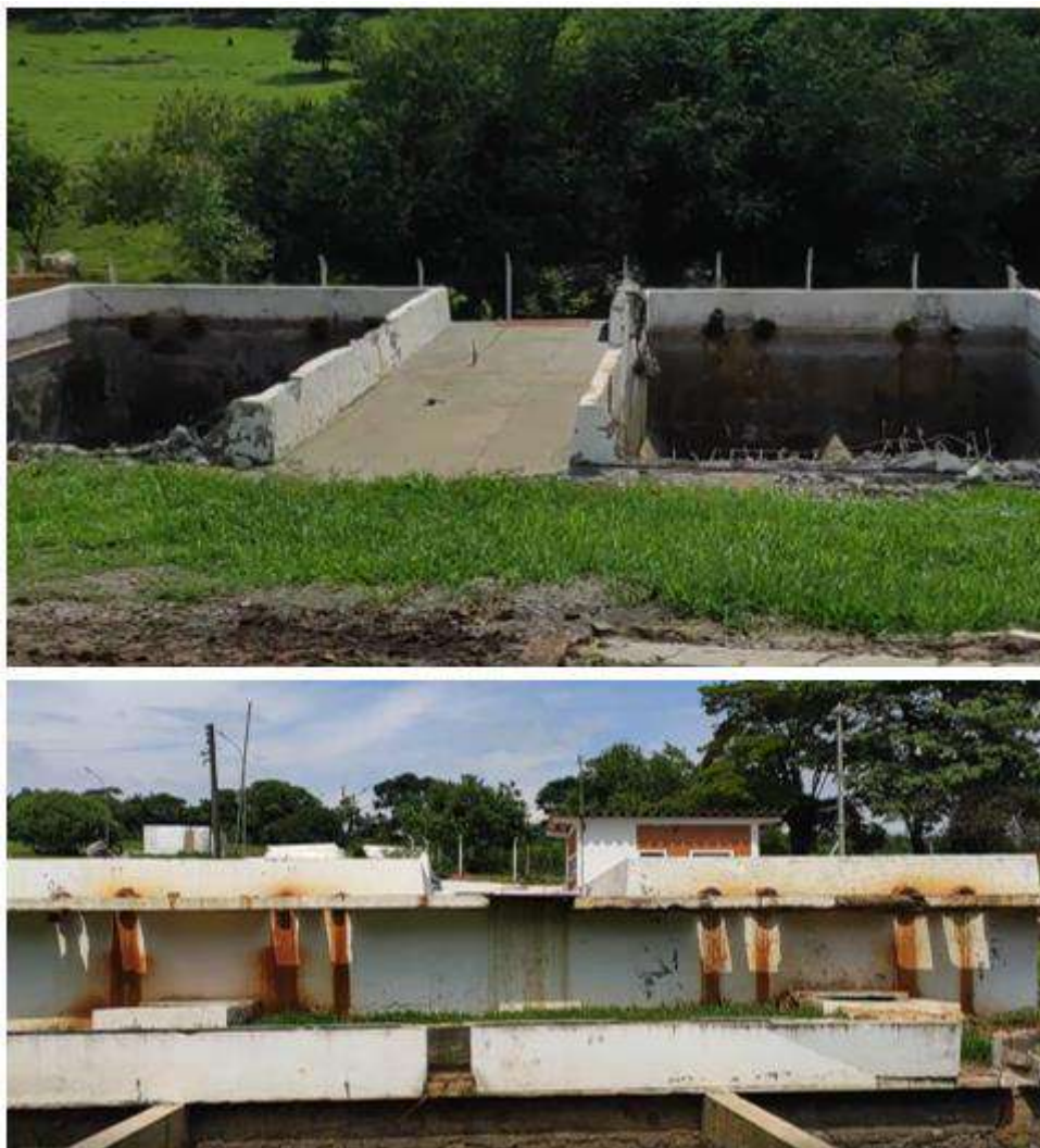
Figura 5-8 – Antigo sistema RAFA de tratamento desativado na ETE Sede Fonte: CONSÓRCIO CM (2021)
