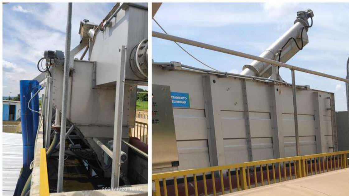
Figura 5-9 – Entrada de esgoto bruto e tratamento preliminar da ETE Sede Fonte: CONSÓRCIO CM (2021)
